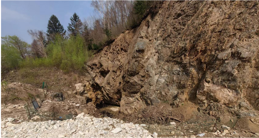
照片2-2 已破坏边坡照片
